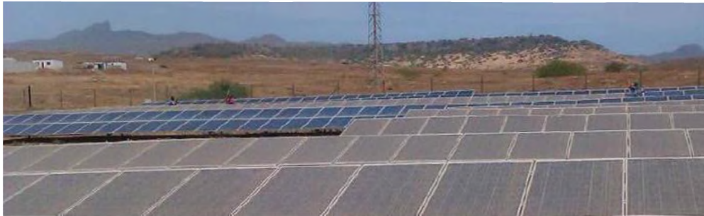
Şekil 3.25 : Sahil yakınındaki, fabrika bölgesine kurulmuş bir PV santral.
