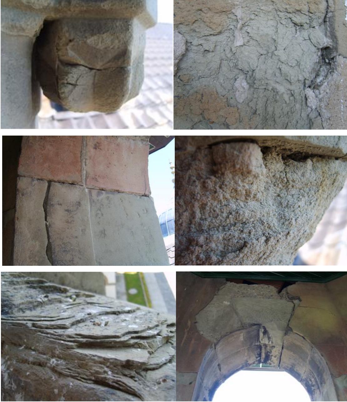
Şekil 3. Kumtaşlarındaki bozulma görüntüleri [7]
