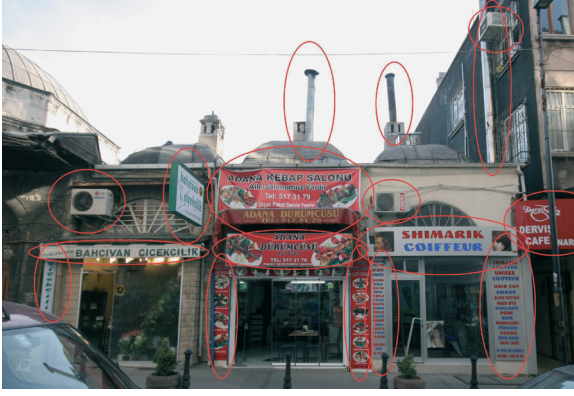
Şekil 61. Köprülü Mehmet Paşa Külliyesine ait dükkanlardaki tabela, klima ve tahliye bacası eklentileri (İ.SAĞDİCİ; 2011)
