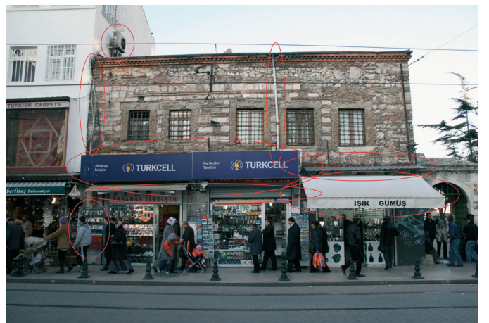
Şekil 56. Atik Ali Külliyesi'ne ait Muvakkithane - Sıbyan Mektebi cephesinde tabela, tente, hatalı uygulanmış yağmur iniş borusu ve klima eklentileri (İ.SAĞDİÇ; 2011)
