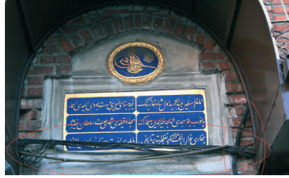
Şekil 50. Mimar Hayrettin Camisi'nin kitabesi ve tesisata ilişkin kabloların görünüşü
