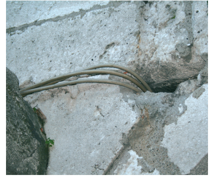
Şekil 46-47. Çorlulu Ali Paşa Camisi avlusu ve giriş kapısında tesisat kabloları ve klima uygulaması (İ.SAĞDIÇ; 2011)
