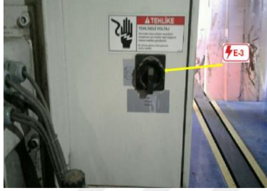
Resim 4.8. Bobin standı ana elektrik enerjisi kesme noktası
