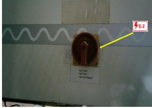
Resim 4.10. Ekleyici (birleřtirici) ana elektrik enerjisi kesme noktası
