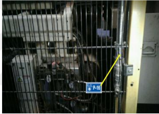
Resim 4.47. Çift yüzey ünitesi basınçlı ana giriş hava enerjisi kesme noktası
