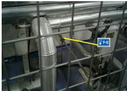
Resim 4.48. Çift yüzey ünitesi kondens sistemi basınçlı hava enerjisi kesme noktası
