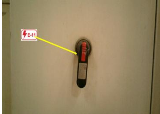
Resim 4.43. Çift yüzey ünitesi ana elektrik enerjisi kesme noktası
