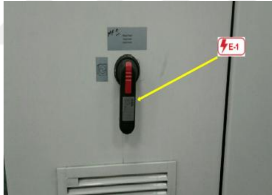
Resim 4.21. Köprü ana elektrik enerjisi kesme noktası
