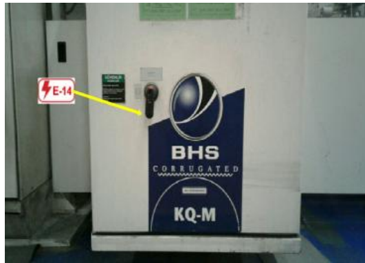
Resim 4.50. Döner kırıcı ana elektrik enerjisi kesme noktası
