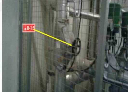
Resim 4.45. Çift yüzey ünitesi buhar giriş enerjisi kesme noktası
