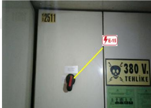
Resim 4.54. İz atıcı ve kesici ana elektrik enerjisi kesme noktası
