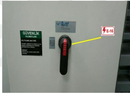
Resim 4.58. Yüksek hızlı kesici ana elektrik enerjisi kesme noktası
