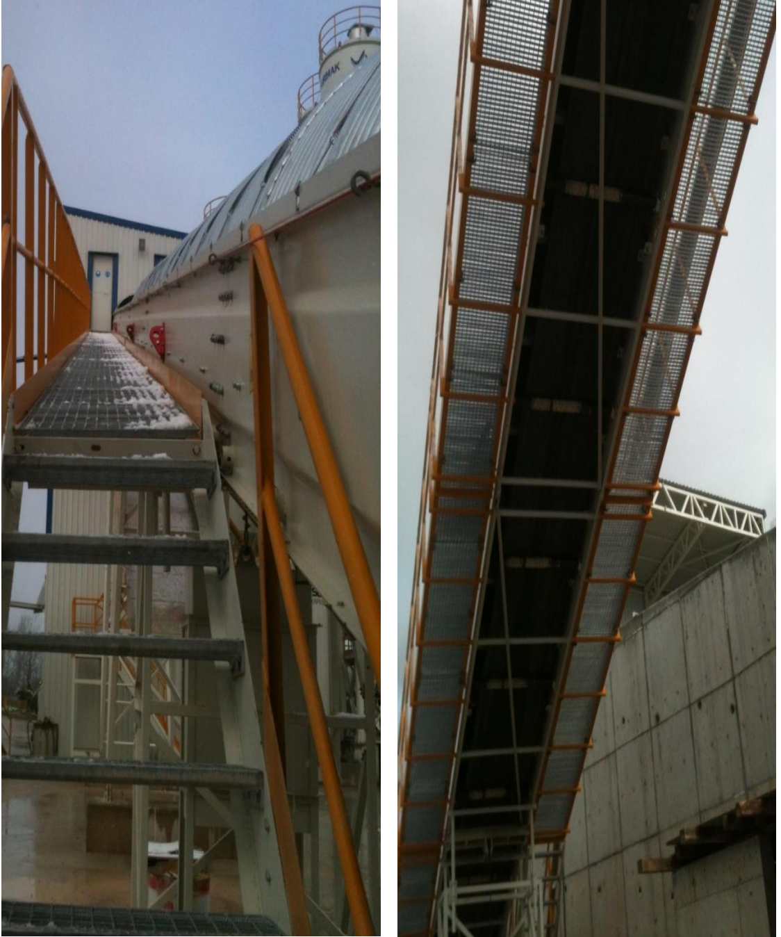
Şekil 5.8 : Agreg taşıma bantı yanında bulunan agrega birikmesine ve çalışanın kayma riskine karşı ızgara platform zemini.
