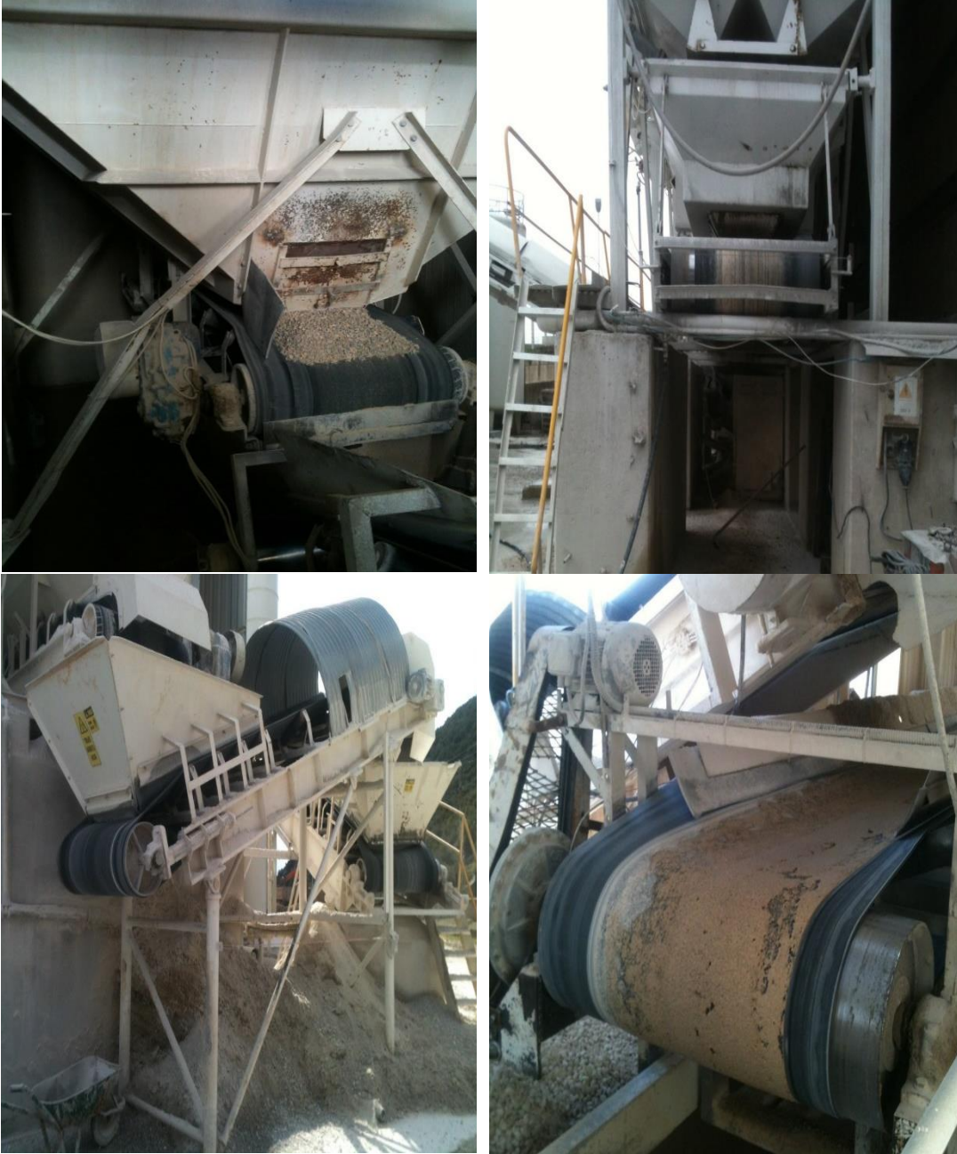
Şekil 4.7 : Agrega taşıma bantlarında açıkta bulunan döner ve hareketli kısımlar.
