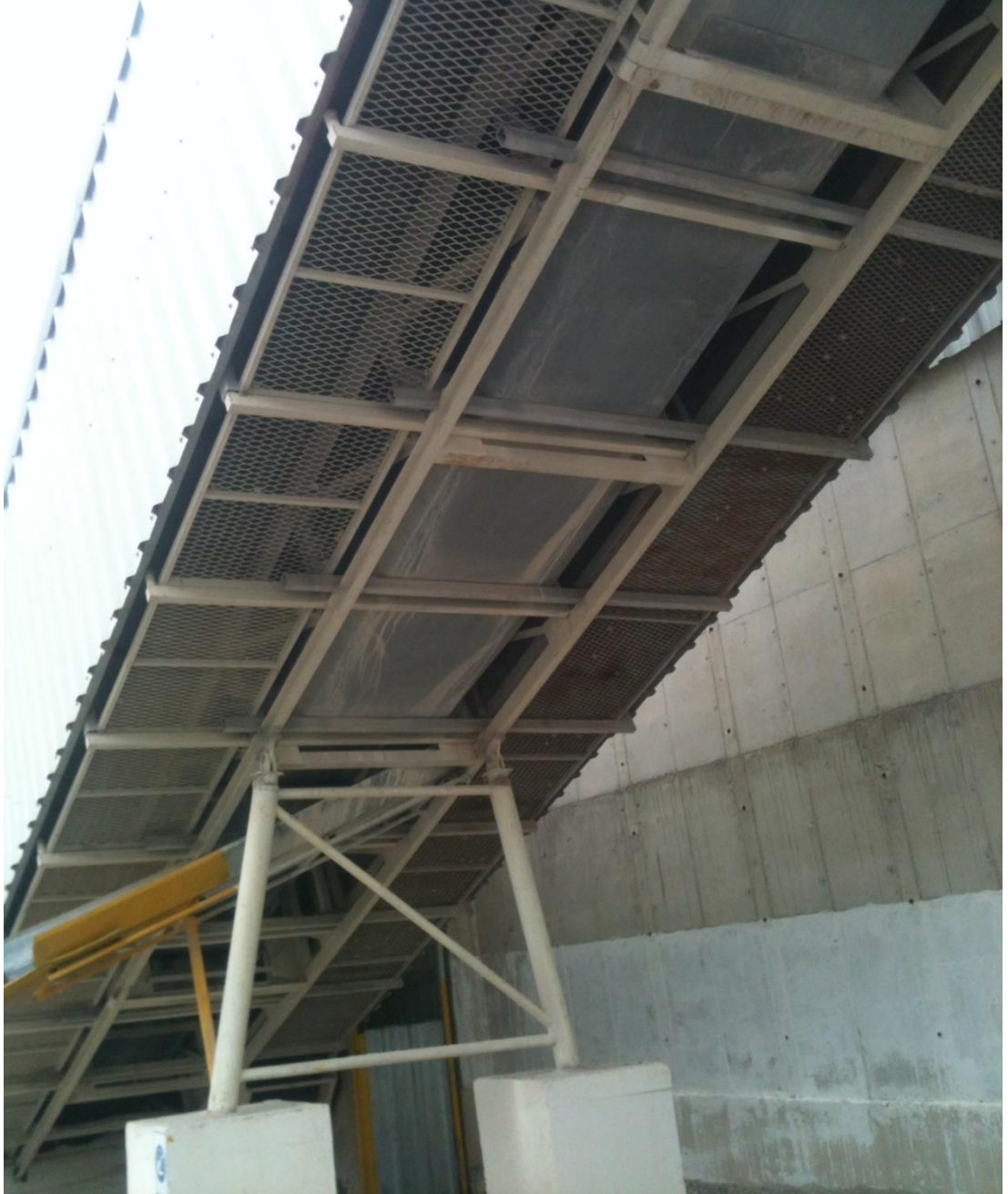
Şekil 4.10 : Agregaların taşıma sırasında düşmesine neden olan bant altı açıklığı.
