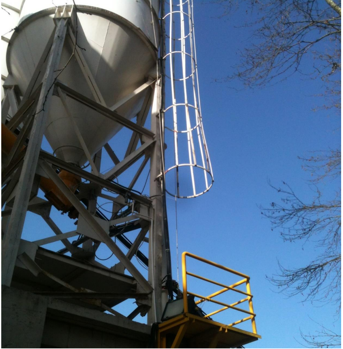
Şekil 4.16 : Kontrollü erişim için kapatılmamış silo gemici merdiveni.
