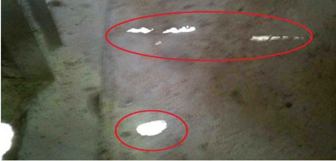
Şekil 4.13 : Santral mikser alanında deformasyona uğramış zemin.
