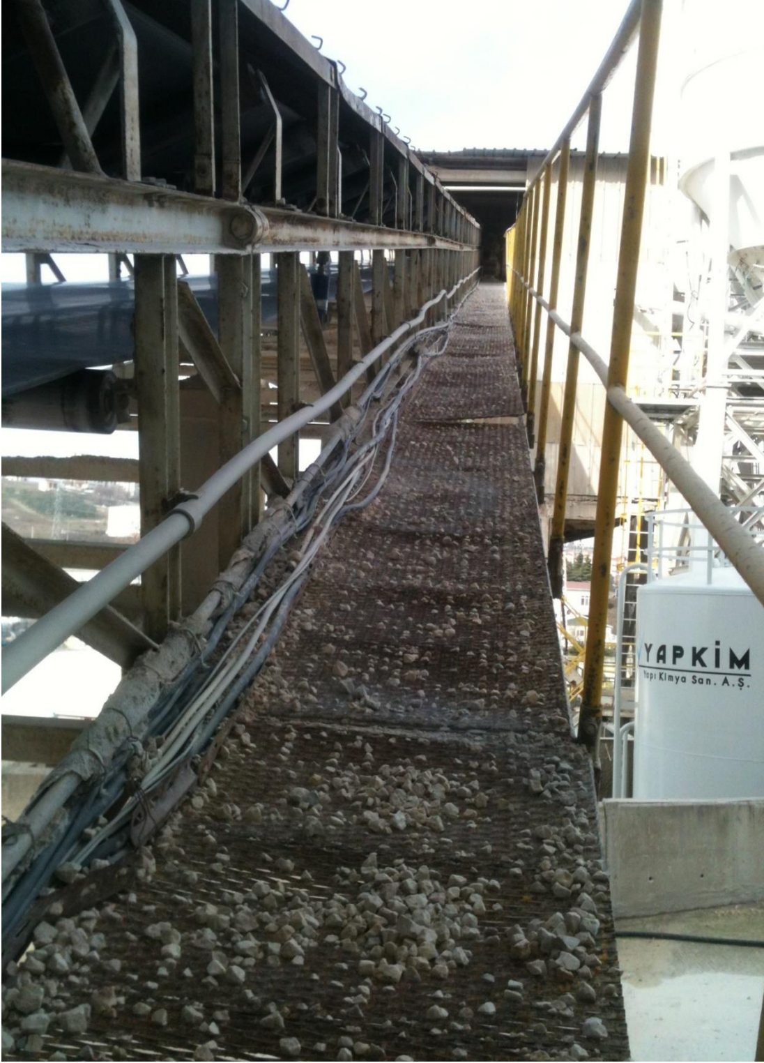
Şekil 4.9 : Agrega taşıma bantı yanında bulunan platform üzerinde biriken agregalar.
