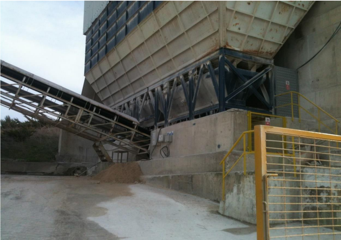
Şekil 3.6 : Bunker tip hazır beton santrali tartım ve taşıma bandı alanı.
